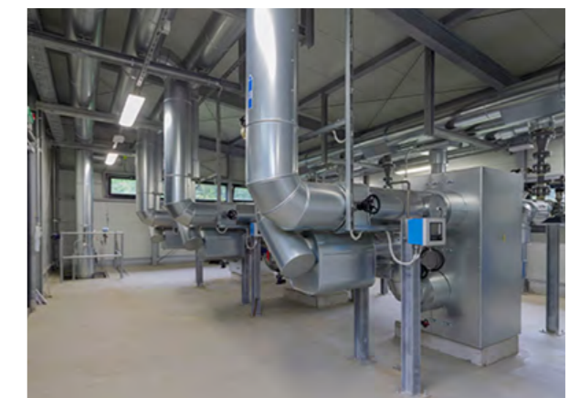
Abbildung 32: Wärmetauscher Geothermie (Quelle: PIZ IUD)
