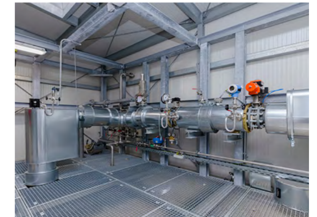
Abbildung 30: Förderbohrung Geothermie (Quelle: PIZ IUD)
